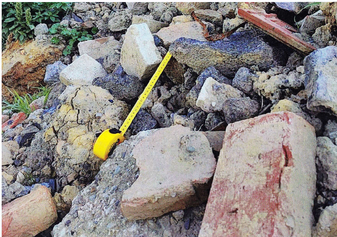
Obr. 6: Stavební odpad v konstrukci vzdušné oddělovací stěny (M 30cm)
