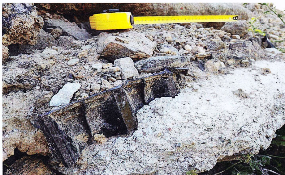
Obr. 5: Výskyt hořlavých materiálů v konstrukci oddělovací vzdušné stěny (M 30cm)
