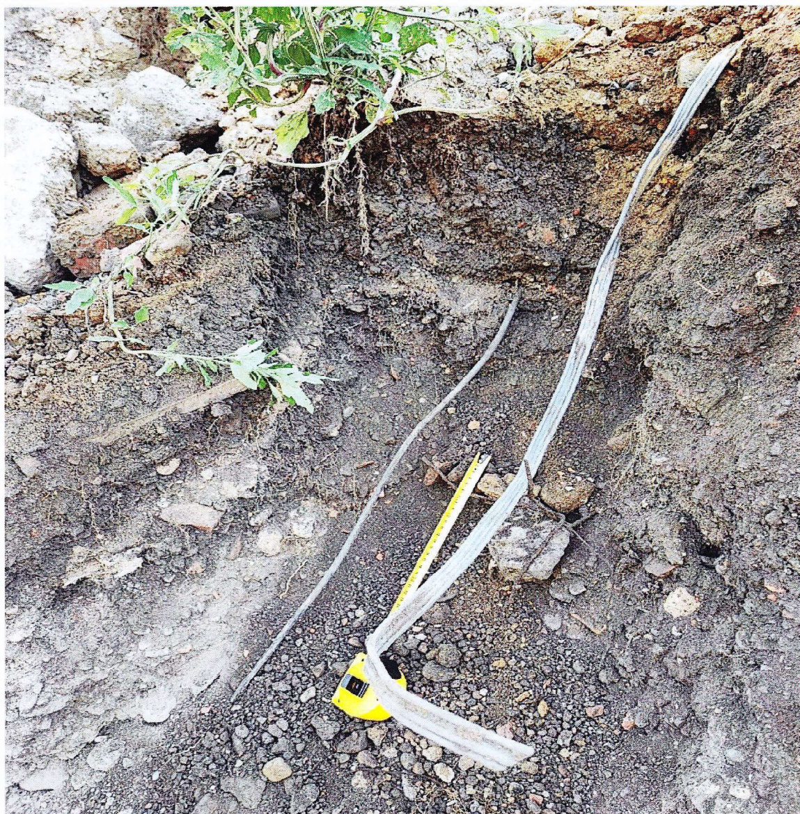
Obr. 8: Hořlavý materiál (kabely) v kontrolní kopané sondě (M 30cm)
