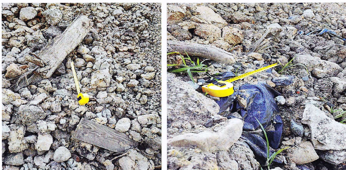
Obr. 3 a 4: Výskyt hořlavých materiálů v konstrukci oddělovací vzdušné stěny (M 30cm)
